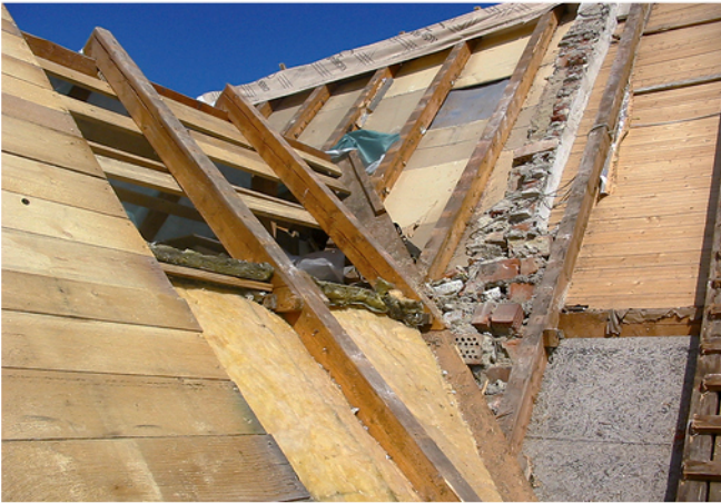
5 Hier würde sich die Sub-und-Top-Verlegung schwierig gestalten: Schräge Gefache und Mauerwerk verkomplizieren das passgenaue Einlegen der Dampfbremse.
