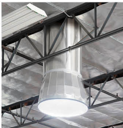
4 Am Endpunkt der Lichtröhren verteilen die Diffuser das Tageslicht breit streuend im Raum.
