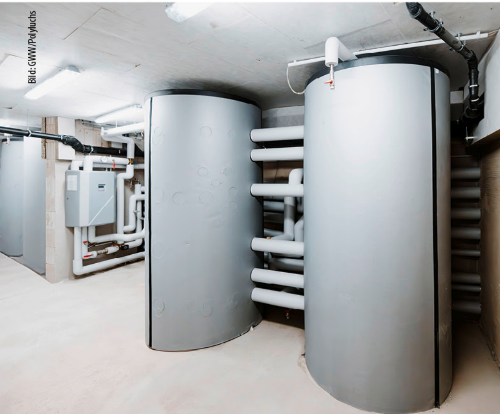
Zwei von vier Pufferspeichern in dem Sonnenhaus
