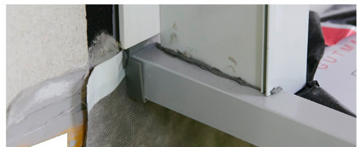
Die untere Abdichtung wird mit dem seitlichen Band verklebt, damit auch noch bis zur Anbringung des WDVS die Dichtigkeit gewährleistet ist.
