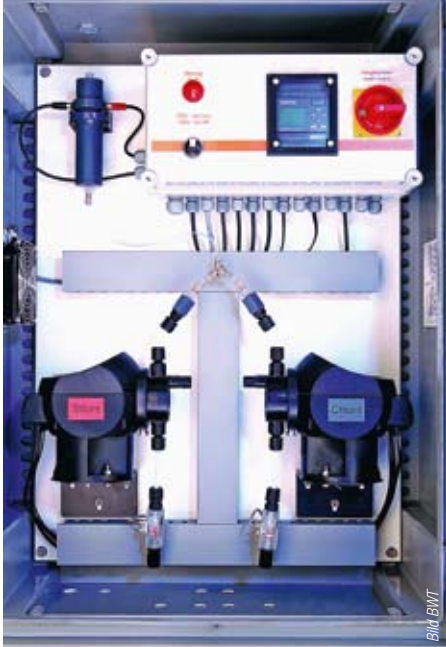
Bild 5 Auf Chlordioxid-Basis bietet das von BWT entwickelte Reaxan-Verfahren zur Desinfektion von Trinkwasser dem Betreiber bei einer Legionellen-Sanierung die Möglichkeit einer zeitlichen Überbrückung, bis alle bautechnischen bzw. betriebstechnischen Maßnahmen durchgeführt wurden.
