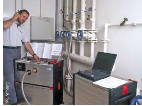
Bild 4 Das Impuls-Spül-Verfahren basiert auf einer kontrollierten Zugabe technisch reiner Luft. Das Reinigen der Leitung erfolgt beim Ausspülen der Luftmolche durch starke Turbulenzen an den Grenzflächen zum Wasser und zur Rohrwand.
