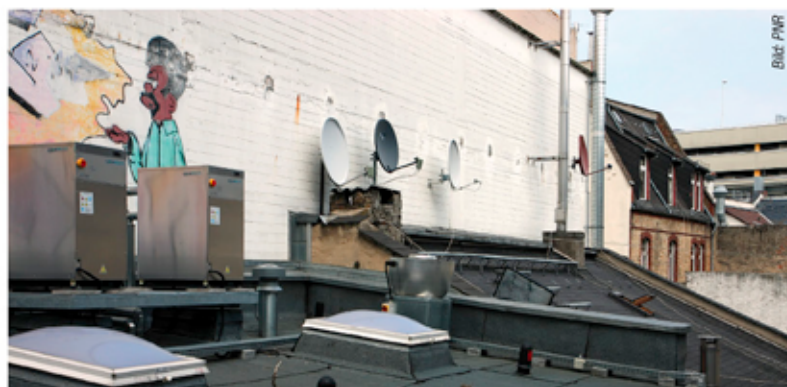
Kunst und Kälte: Links vor dem Graffiti stehen die beiden Kaltwassererzeuger mit jeweils rund 10 kW Kälteleistung.
