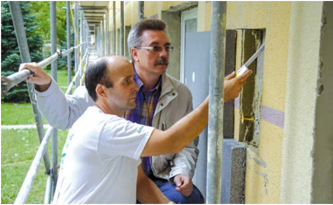
Vor einer eventuellen Aufdopplung muss das Altsystem geöffnet werden, um seine Standfestigkeit und Tragfähigkeit zu ermitteln.
