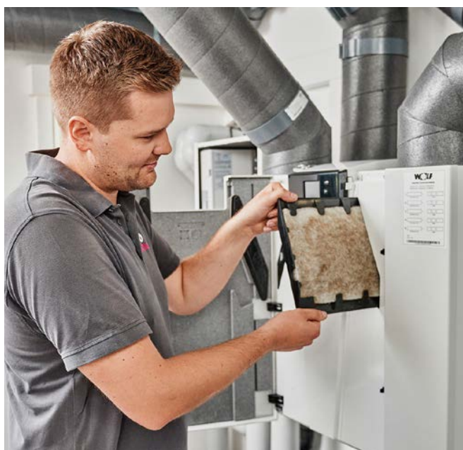
Die Filter einer Wohnraumlüftung gehören mindestens alle drei bis sechs Monate gesäubert beziehungsweise gewechselt.
