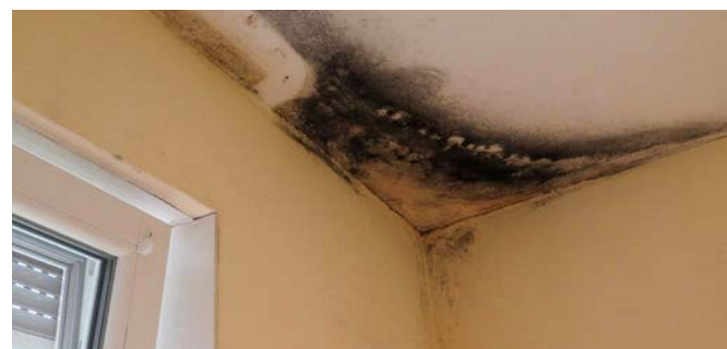
3 Werden lediglich undichte alte Fenster durch dicht schließende moderne ersetzt, schlägt sich nicht mehr abgeführte Feuchte an geometrischen Wärmebrücken nieder und kann zu Schimmelbefall führen.
