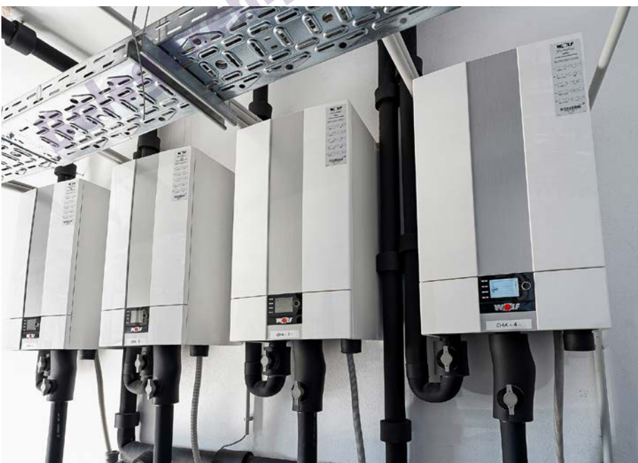
Um flexibel hohe Ansprüche für Warmwasser, Heizung oder Kühlung zeitlich getrennt oder parallel zu erfüllen, werden die Wärmepumpen-Innenmodule an einen gemeinsamen Vorlauf angebunden.
