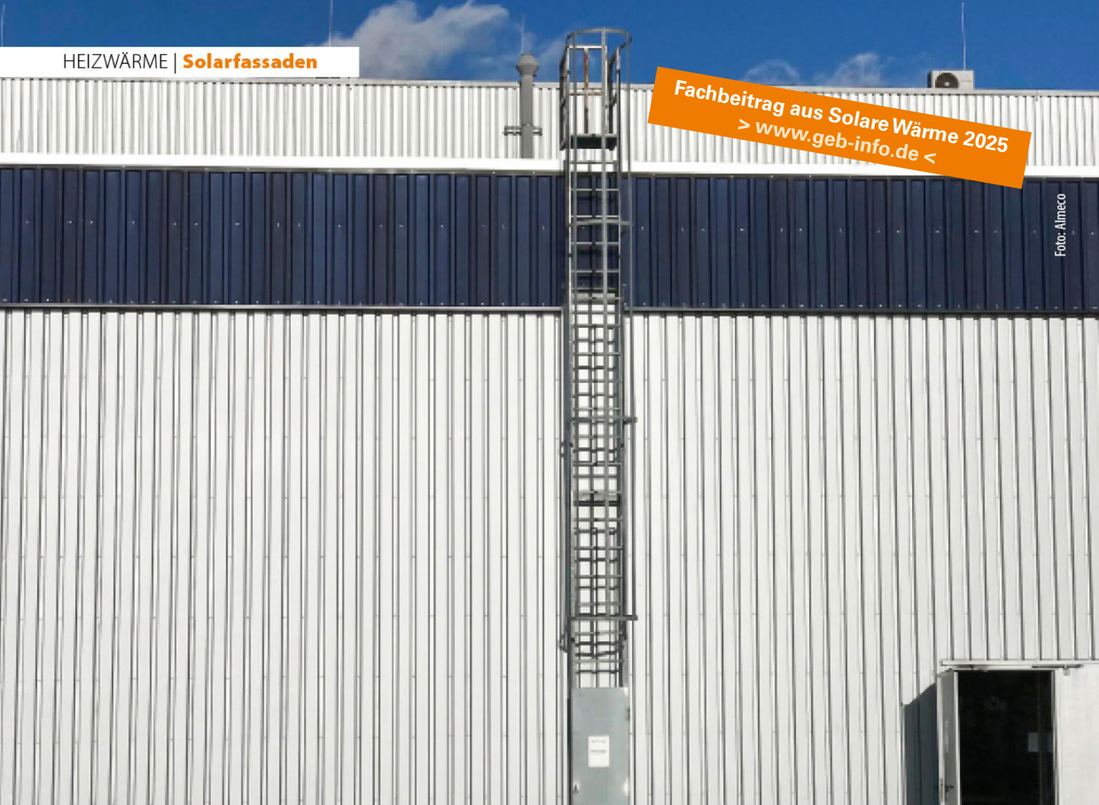
Solarluftkollektoren an der Bernburger Logistikhalle von Almeco
