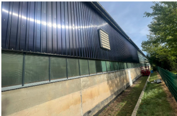
Solaluftkollektorfassade an der Halle von Homatec
