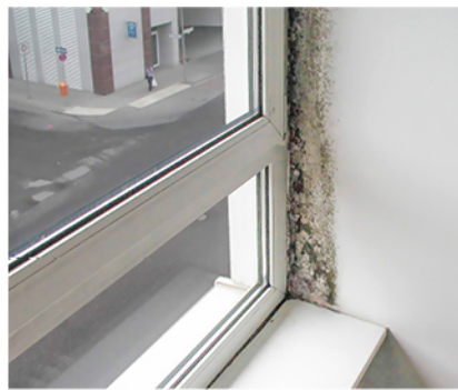
2 Wo die 13°C-Isotherme verläuft, sieht man hier ganz deutlich. Frei nach Bauschäden-Papst Raimund Probst: „Der Schimmelstreifen zeigt an, wo das Fenster gerne eingebaut worden wäre!“
