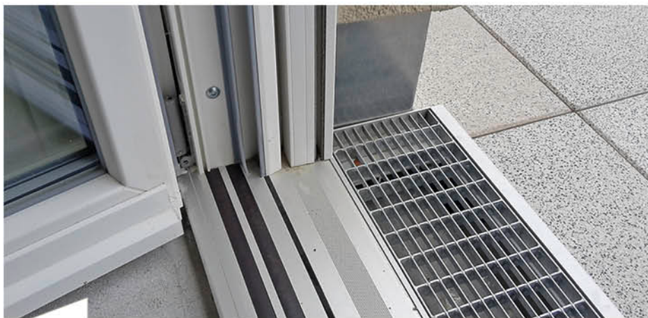
Auf diesem Bild ist die eingebaute Magnet-Doppeldichtung noch ohne Fertigfußboden im Innenraum zu sehen. Falls die Fußböden über geringere Aufbauhöhen verfügen, kann das Aluminium-Bodenprofil der Magnet-Doppeldichtung diesen Höhenunterschied ausgleichen.
