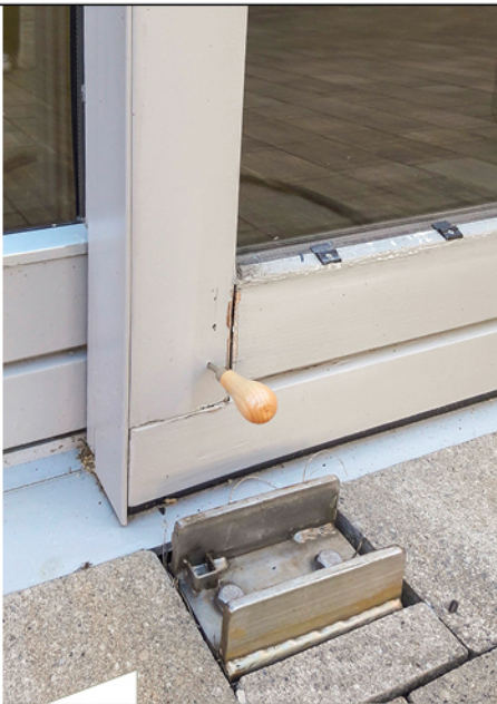
Bild 2: Schaden rechtzeitig erkannt
