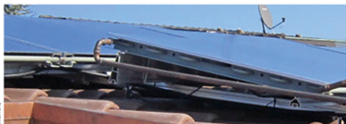
4 Aufgeständerte Kollektormontage bei der untersuchten Anlage: Das geschlossene Aufständersprofil (Oberkante Kollektor) behindert die rückseitige Luftzirkulation.
