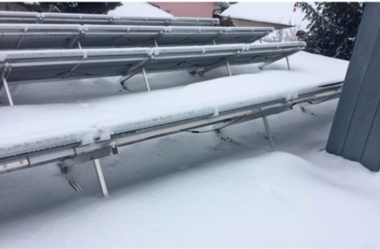
11 Solink-Anlage mit Schnee. Die Rückseite mit der Wärmeübertragungsfläche zur Luft ist frei.
