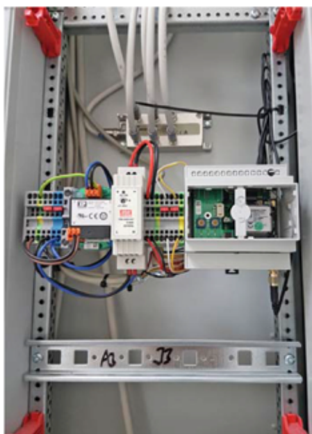
Der Controller inklusive M2M-SIM-Karte der Telekom sitzt im Sicherungskasten.
