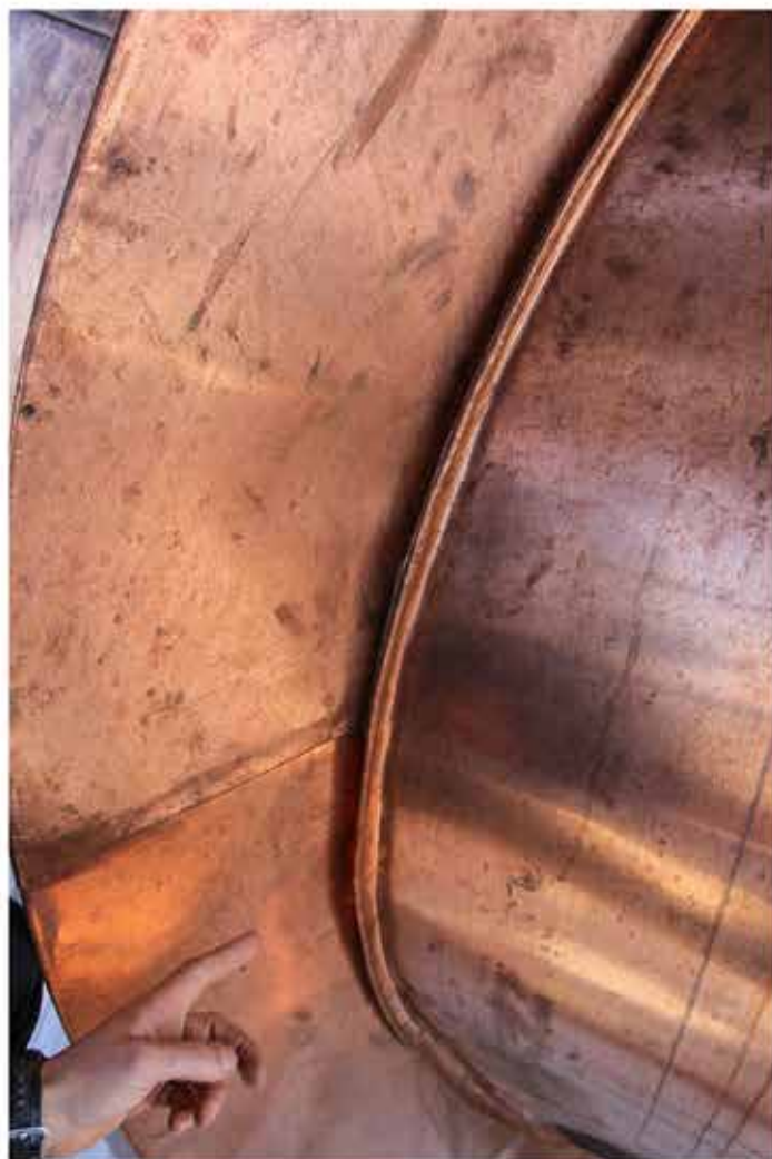
Die Seitenblenden der Lisenen wurden am Übergang zur Zwiebeleindeckung aufwendig dem Scharverlauf folgend eingefalzt
