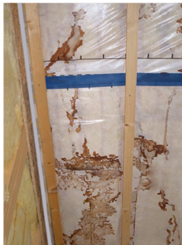
6 Fehlende Abklebung oberhalb der Innenwand bei einer Holzkonstruktion. Hier hätte ein Folienstreifen gereicht, der bei der Montage über die Wand gelegt und hinterher beidseitig angeschlossen wird.
