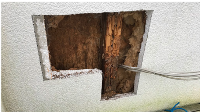
8 Bei diesem Fall fehlte die Abklebung der luftdichten Ebene am Flachdachanschluss zur Außenwand unterhalb der Attika. Da bei der Montage der Attika aus statischen Gründen ein Teil der OSB-Platte das darunter liegende Wandelement überlappte, wurde die fehlende Abklebung an dieser Stelle nicht bemerkt. Dazu kommt, dass die Beplankungen der Attika beidseitig einen hohen s_d -Wert aufweisen und eingedrungene Feuchte nicht ausdiffundieren konnte. Der Blower-Door-Test war mit einem n_{50} -Wert von 0,55 \text{ h}^{-1} zufriedenstellend. Die Leckagen bzw. Lufteintrittsstellen waren vorwiegend die Elektroinstallationsdosen im Dachgeschoss. Entlang der Brettstapellamellen konnte sich die Luft ihren Weg bis in die Attika bahnen.
